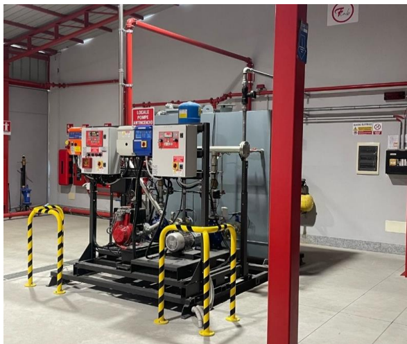
Gruppo di pompaggio per rete idrante e impianto sprinkler
