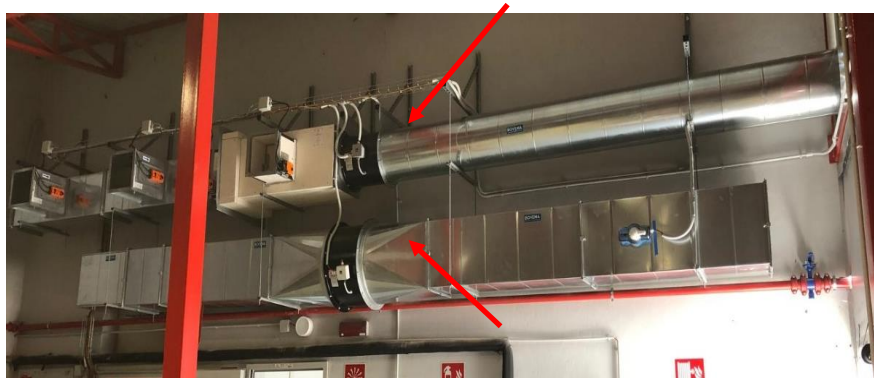
Sistema di controllo del fumo a differenza di pressione
